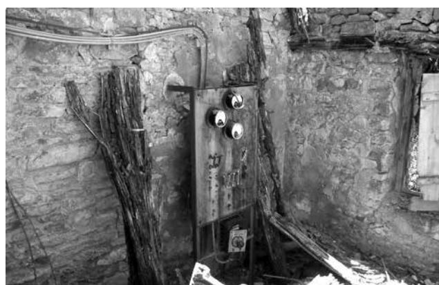
Panel de control en la pared sur
