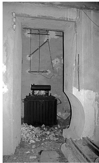
Transformador y conexión con la red eléctrica
