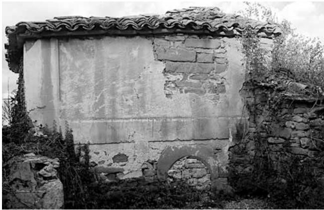
Fachada con elementos extraños
