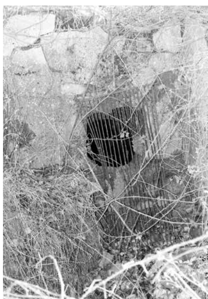
Embalse con rejilla metálica— 2020
