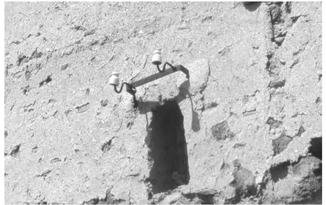
Los aisladores por encima de la ventana de izquierda — 4
